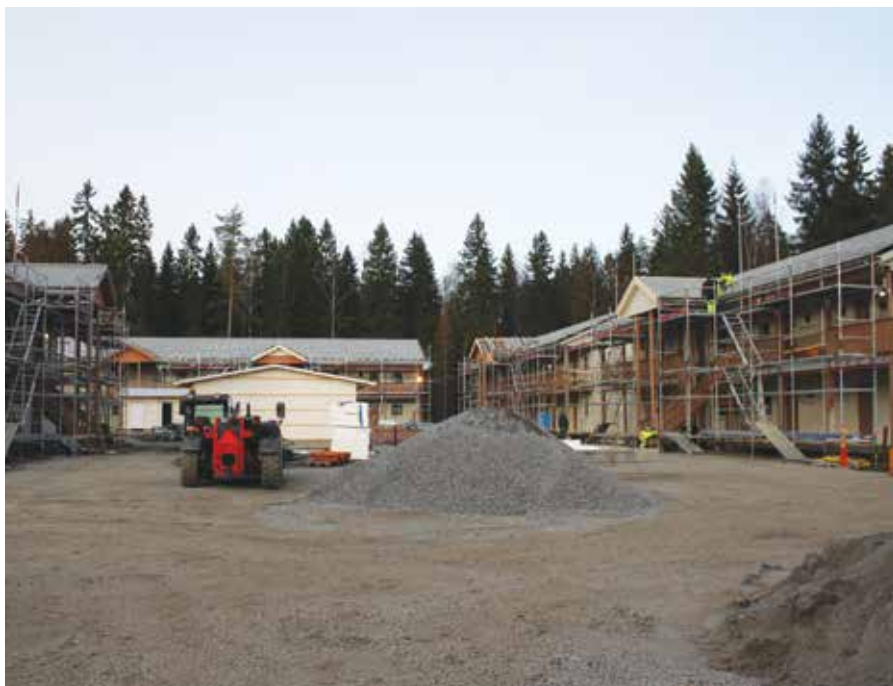
De nybyggda fastigheterna på Maskinförarevägen värms upp med Nykvarns största bergvärmeanläggning.
